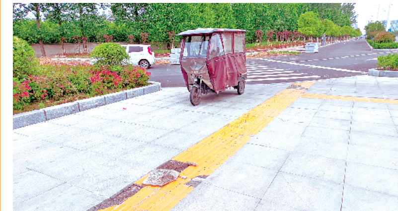
5 月 11 日,记者在腾飞路与庆丰东路交叉口发现,非机动车和行人等待区路面基石损坏严重,亟待修缮。
