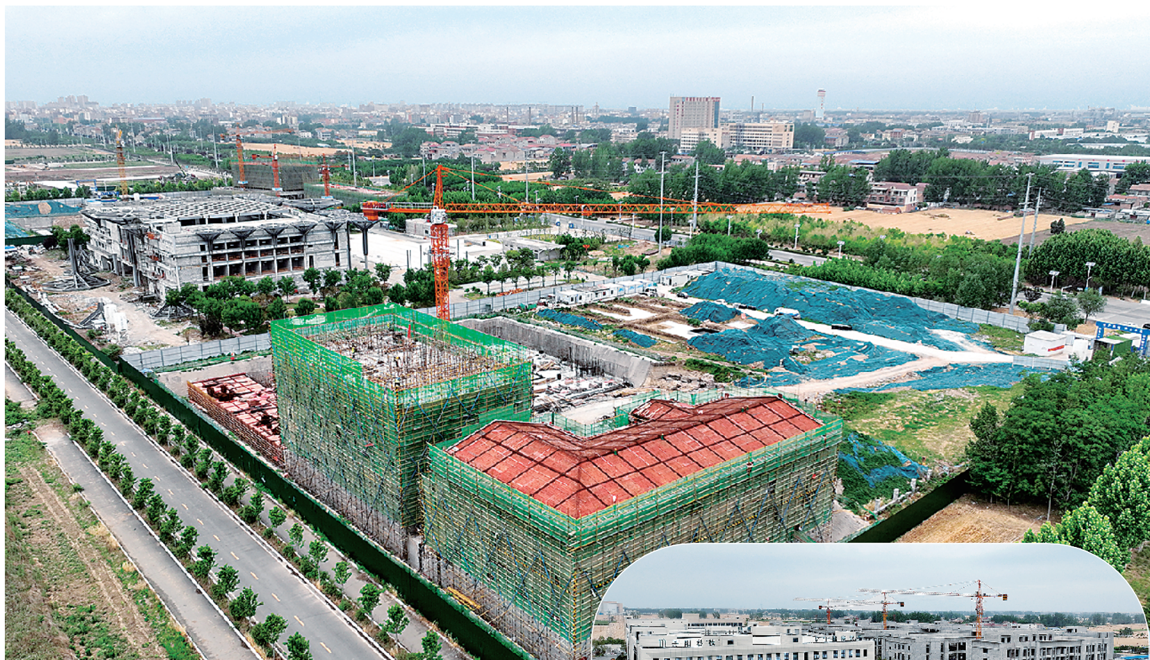
6月4日，记者在郸城县各大重点项目建设现场看到，施工人员各司其职、密切配合，加速推进重点项目建设，为郸城高质量发展发展蓄势赋能。
