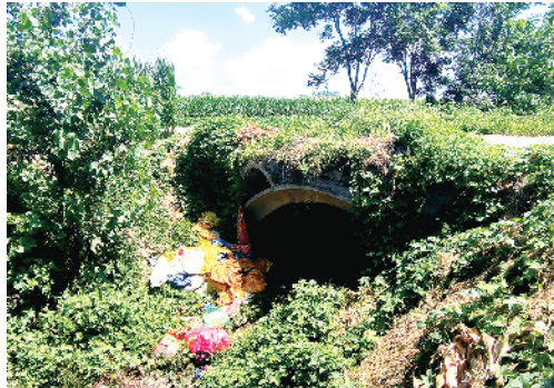
沈丘县邢庄镇西刘营西南头桥下,生活垃圾和秸秆堆积
