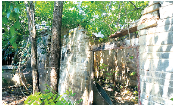
沈丘县邢庄镇西刘营村内,破旧民房残垣断壁、岌岌可危
